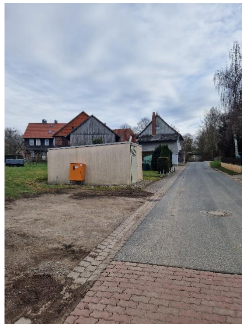
Trafostation Unterm Baumhof; eigene Darstellung
